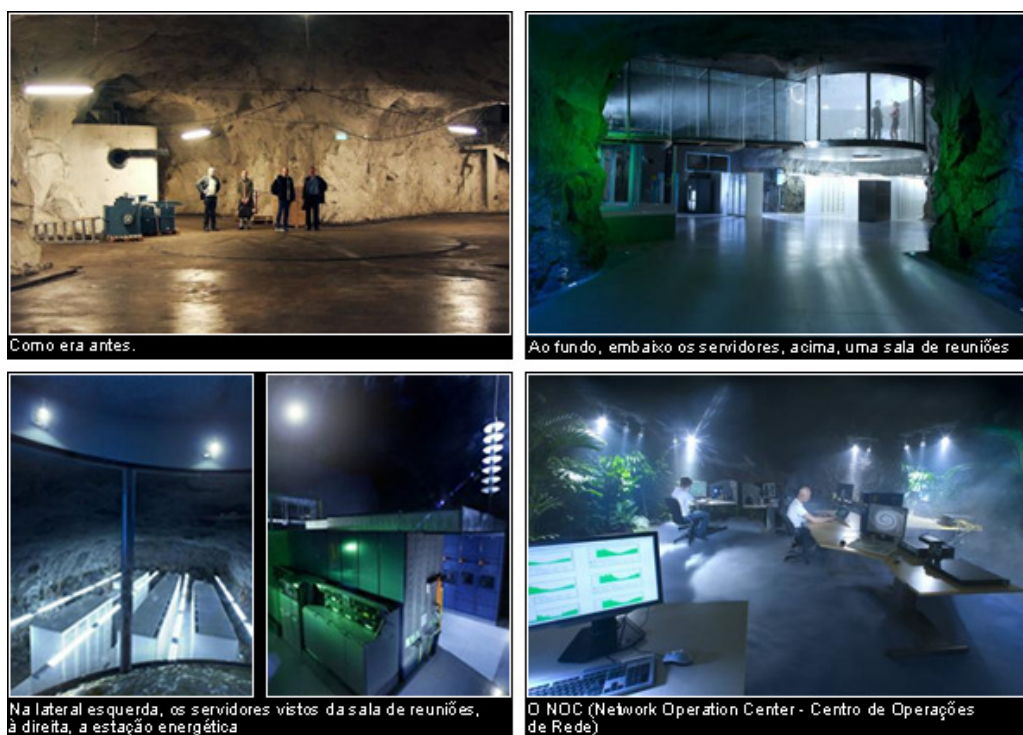
Figura 9 – Outras visões do Datacenter Pionen White Mountains Subterrâneo 9
